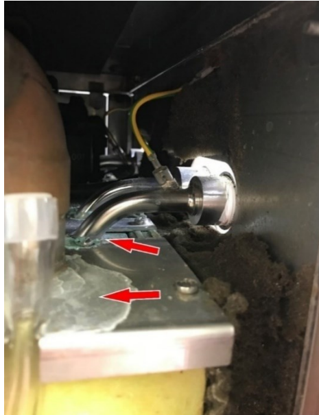
Abbildung 19: Trocknungsflecken und Korrosion im hinteren Bereich des Tankdeckels
