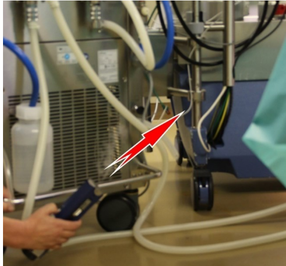
Abbildung 33: Luftströmung aus der HCU an deren Rückseite
