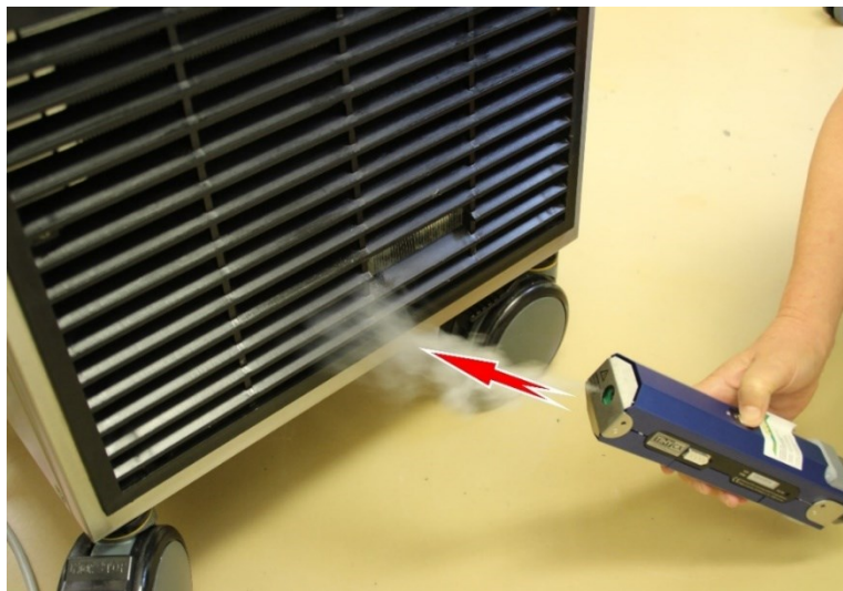
Abbildung 32: Sog am Zuluftgitter der HCU
