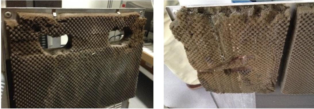
Abbildung 23: Zustand der Gehäusedämmung
