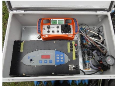
Abbildung 87: Kiste mit den elektronischen Steuerteilen
