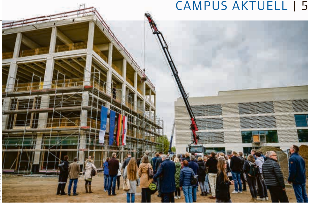
Höhepunkt des Richtfestes: Zimmermann Claus-Peter Stork, Firma Dörr Dach + Wand, verliest den Richtspruch.
