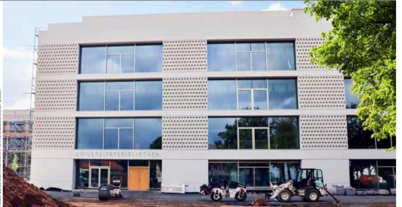
Neubau der Universitätsbibliothek Gießen. Der neue Forschungslesesaal wird sich im zweiten Obergeschoss im Bereich des Fensters ganz links befinden.
