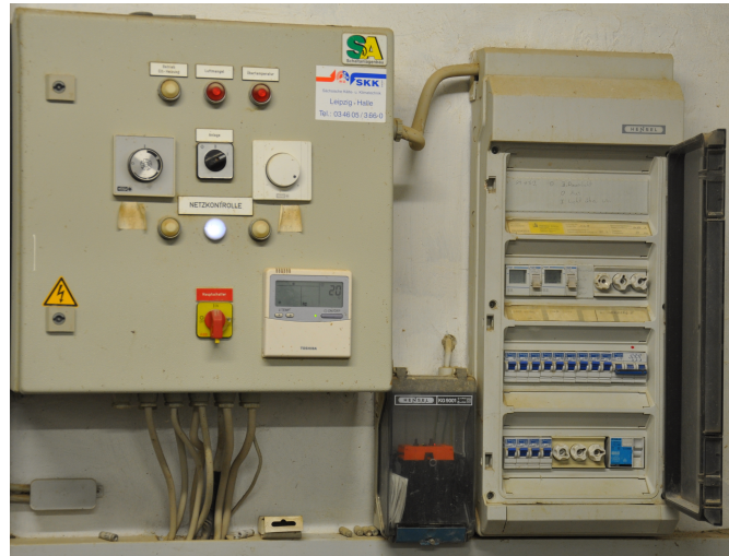
Abbildung 4.2: Die Steuereinheit für die Lüftungs- und Klimaanlage
