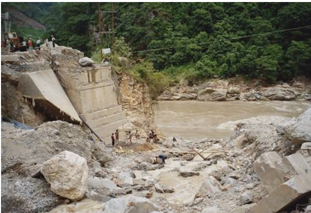
Bild 3-3: Durch einen Erdrutsch zerstörte Brücke bei Mugling
