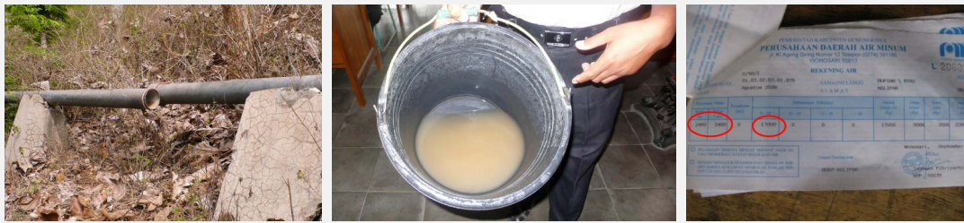
Abb. 55: Wesentliche Probleme der Wasserbereitstellung durch PDAM. Die Bilder zeigen von links nach rechts: Defekte und trockene Wasserleitung (EIGENE AUFNAHME 2008), Wasserqualität in der Regenzeit (EIGENE AUFNAHME 2008), Preisgestaltung von PDAM (HÜLSMANN 2009: 95). Die roten Kreise zeigen, dass der Zählerstand im Abrechnungszeitraum unverändert blieb und folglich kein Wasser floss, die Gebühren jedoch trotzdem entrichtet werden müssen.
