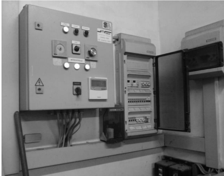
Abb. 20: Steuerelement der Klimaanlage (Toshiba)
