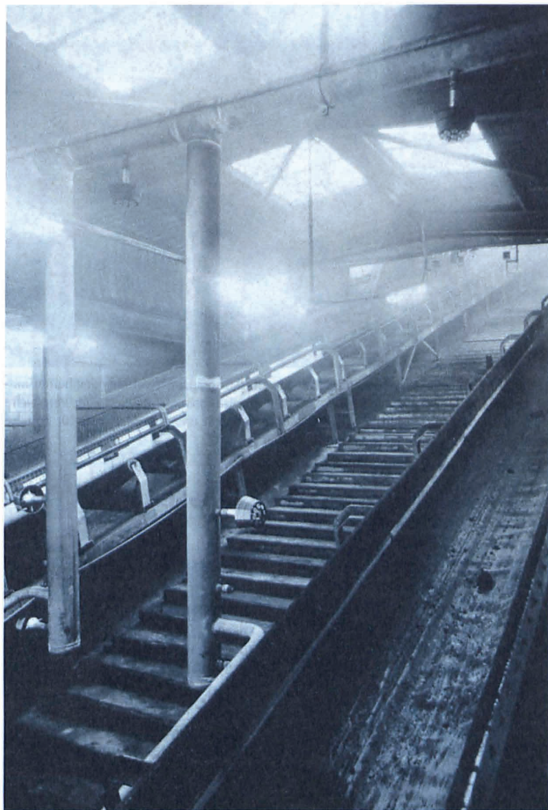
Eine Schrägbandbrücke mit zwei Förderbändern in der Bekohlungsanlage des Kraftwerks Niederaußem. In dem Braunkohlestaub, der von den Förderbändern weht, können Schwelbrände entstehen, die kaum Rauch entwickeln.
