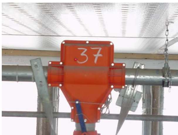
Abb. 26: Elektrisches Schließventil auf einem Volumendosierer
