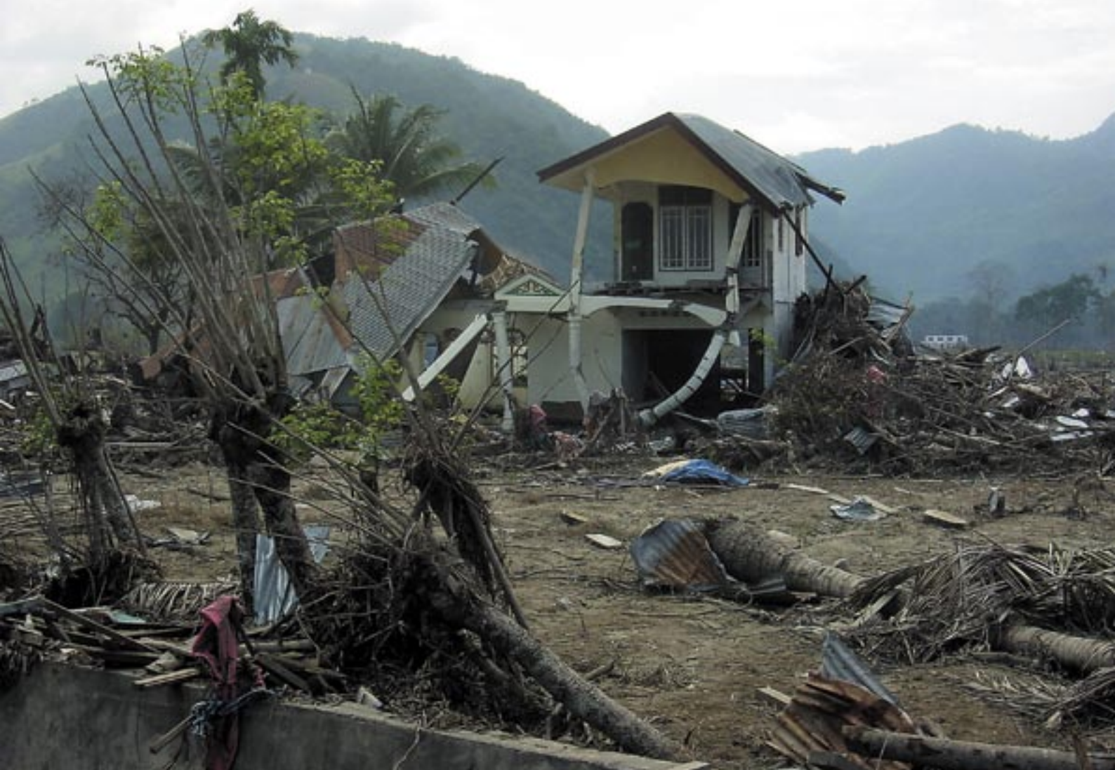
Der Tsunami hatte eine derartige Wucht, dass auch noch Kilometer von der Küste entfernt Stahlbetonsäulen verbogen wurden.
