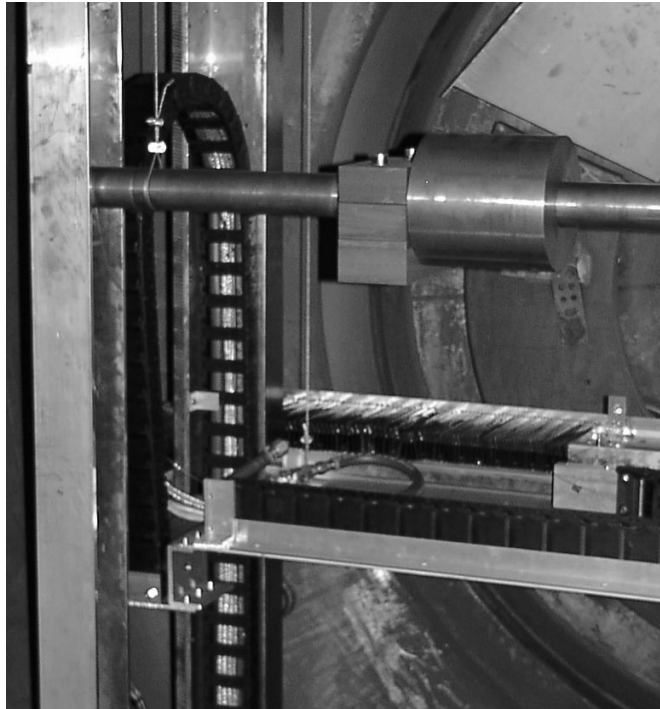
Abbildung 3-7: Blick auf die vertikale Kabel- und Kühlwasserführung
