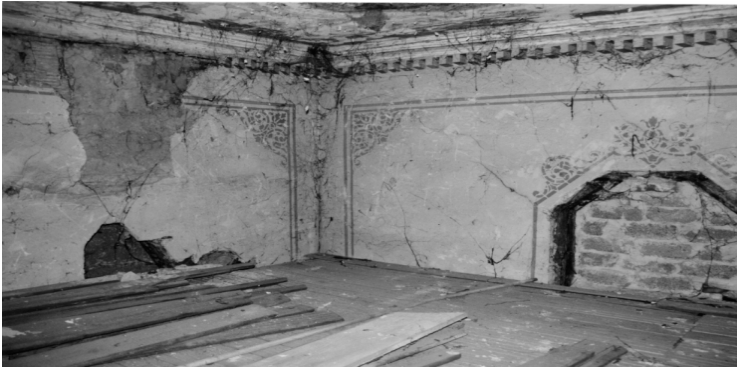
Abb.. 9: Nordwestecke mit Übergang zu Decke, Nov. 2003
