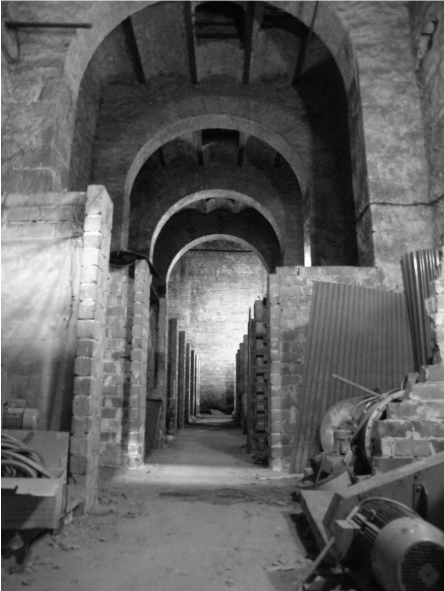
Der verbliebene Keller der Gießener Actienbrauerei liegt unter dem Fabrikgebäude am Leibgesterner Weg.
