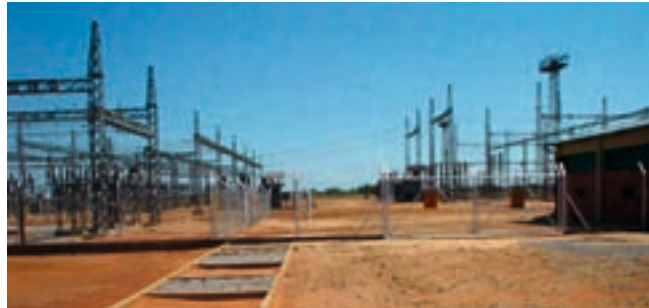
Gerus HGÜ-Umspannwerk Namibia
