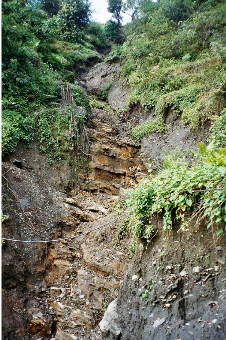
Foto 4: Teilstück der Rutschung bei Komronada, die den Boden bis auf das Grundgestein abgetragen hat (Aufnahme: M. LÖBNER & C. SCHMELZ).
