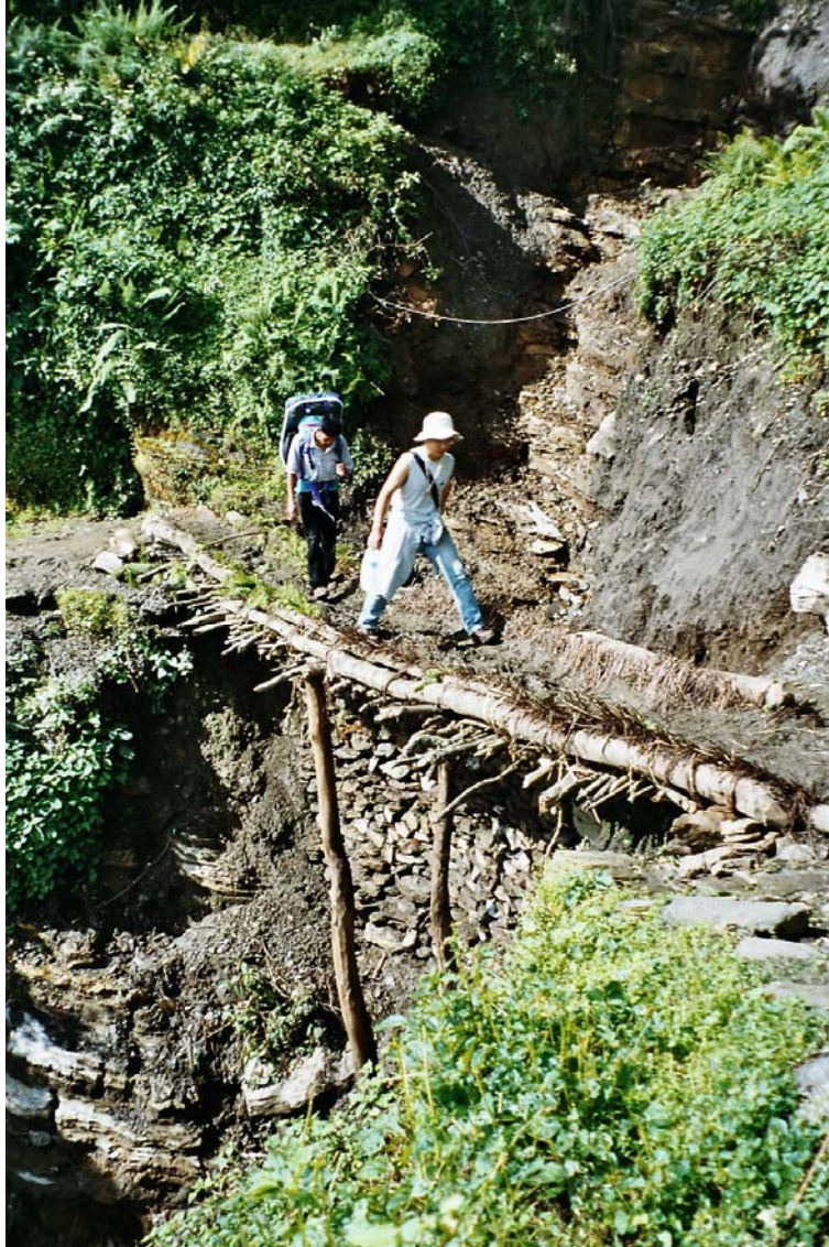
Foto 5: Instandsetzung des durch die Rutschung bei Komrondada zerstörten Weges durch den Bau einer behelfsmäßigen Brücke und durch den Versuch, die Rutschung mit Hilfe einer Steinmauer zu stabilisieren (Aufnahme: M. LÖBNER & C. SCHMELZ).
